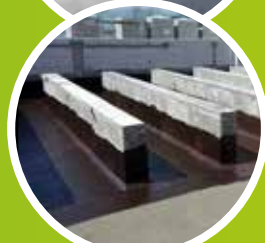
VECCHIE GUAINE BITUMINOSE
